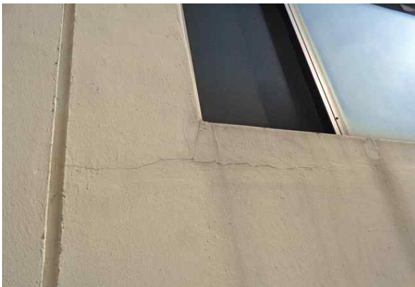
슬러지펌프장 외부 벽체 균열 (CW=0.2mm, L=3.0m)
