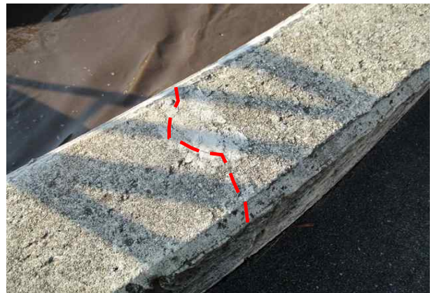
외부 벽체 균열 (CW=0.2mm, L=0.5m)
