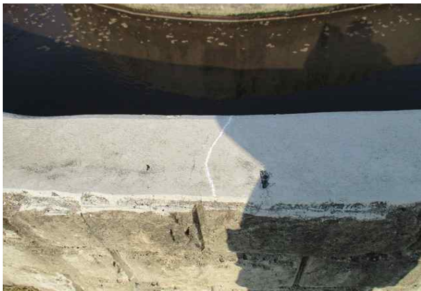
외부 벽체 균열 (CW=0.1mm, L=1.0m)
