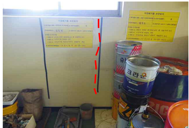
창고 내부 벽체 균열 (CW=0.3mm, L=2.0m)
