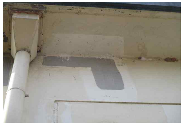
유입펌프장 외부 벽체 백태 (A=0.1m×1.0m)
