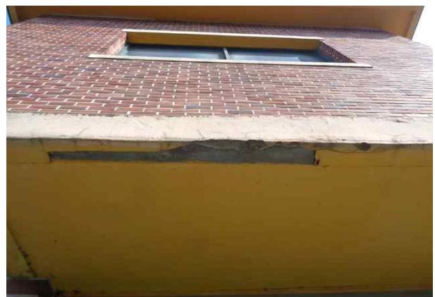
외부 출입구 마감재 탈락 (A=1.0m×1.0m)
