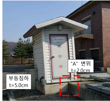
설비 지반침하에 의한 구조물 이격 (L=0.5m)
