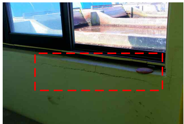
내부 벽체 콘크리트 들뜸 ( A=1.0\text{m} \times 0.1\text{m} , 2EA)
