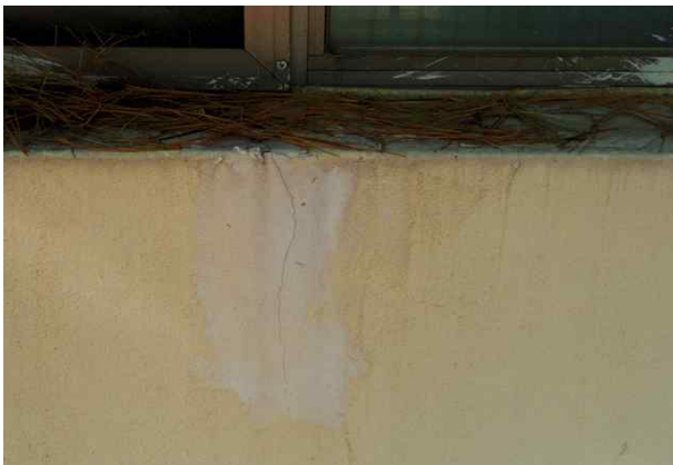
외부 벽체 마감 균열 ( CW=0.2mm , L=1.5m , 4EA)
