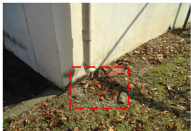
유입펌프장 외부 배수처리시설 미흡 (1EA)
