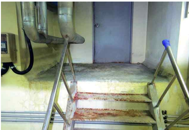
내부 지하층 바닥 콘크리트 박리 (A=2.0m×2.0m)
