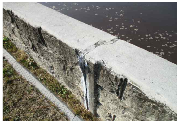
외부 벽체 조인트부 파손 (L=0.5m)
