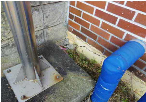
외부 벽체 콘크리트 파손 ( A=1.0\text{m} \times 0.2\text{m} )
