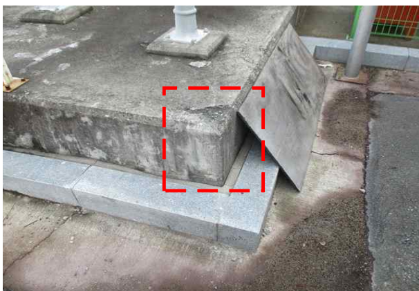
외부 바닥 콘크리트 파손 (A=0.2m×0.2m)
