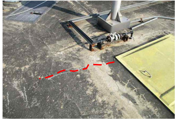
외부 바닥 균열 (CW=0.2mm, L=2.5m)
