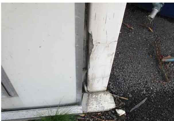
유입펌프장 외부 벽체 마감재 박락 (A=0.1m×0.3m)
