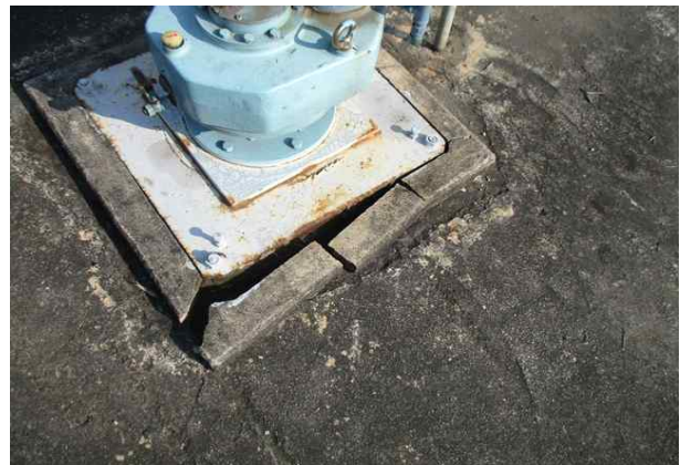
외부 바닥 설비 받침 콘크리트 박락 (A=0.5m×0.3m)
