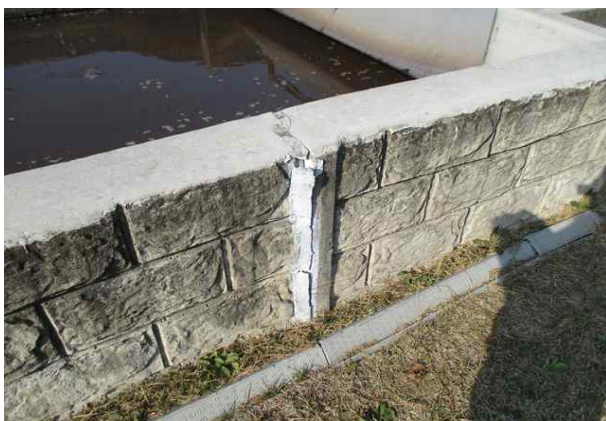
외부 벽체 조인트부 파손 (L=0.5m)
