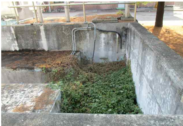
소독조 내부 전경
