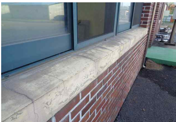
외부 벽체 마감 망상균열 (A=0.5m×3.0m)
