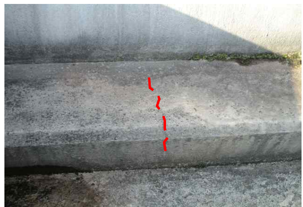
외부 벽체 균열 (CW=0.2mm, L=1.0m)
